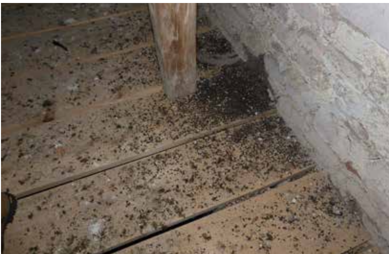
Fledermauskot im Dach des Kirchenschiffs der Klosterkirche St. Martin in Dietramszell
