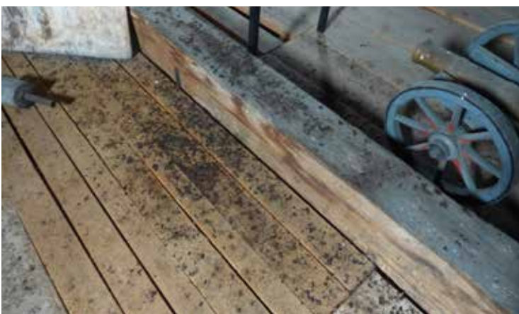
Fledermauskot im Dach des Kirchenschiffs von St. Korbinian, Reichersbeuern
